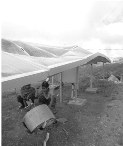
図4 落下したプロペラ部分と破損したソーラーパネル
