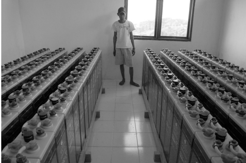
図3 発電施設の管理を任された若者。蓄電用バッテリーが並ぶ管理小屋内で。
