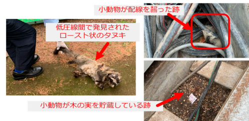
図 5. 小動物侵入形跡と感電した小動物の死骸。
