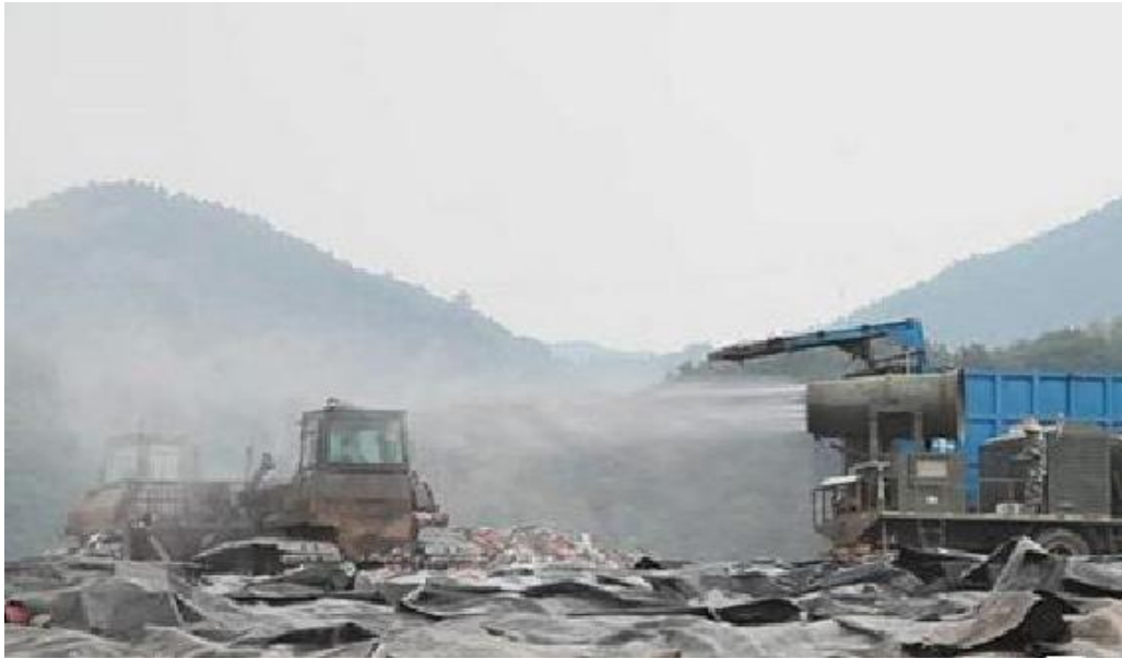
図 4-6 長沙市ゴミ第一中間処分場（破碎工程）（出典：中国 feijiu.net 2016）
