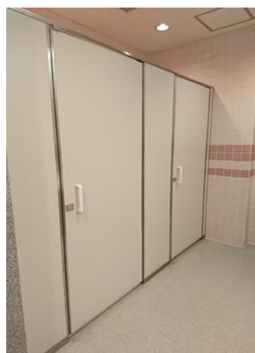
図 2-35 ハンドルが取付けられた外開戸
